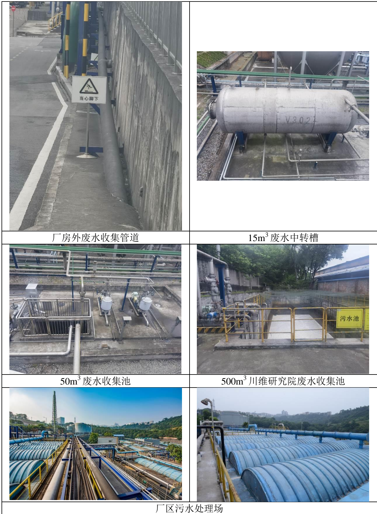
图 4.1-3 废水污染治理设施
