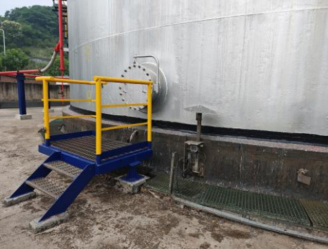
甲醇罐区设置收集沟
