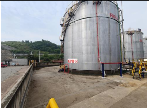
甲醇罐区设置围堰及报警仪
