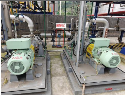
泵区可燃气体报警仪
